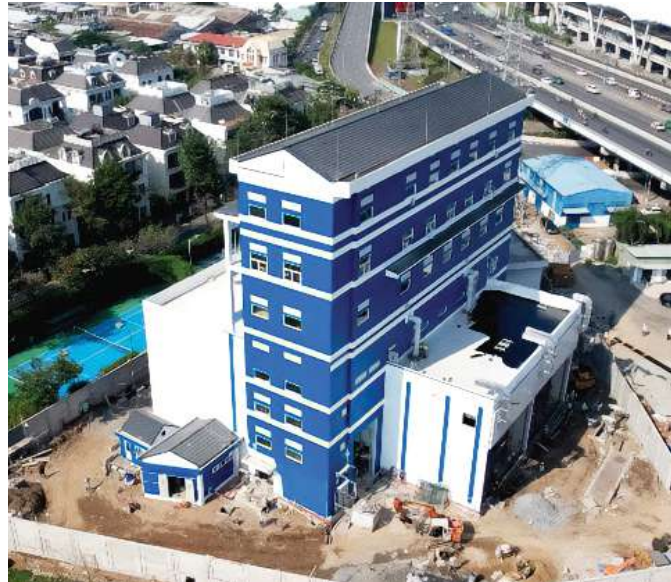
Trạm biến áp 220kv
